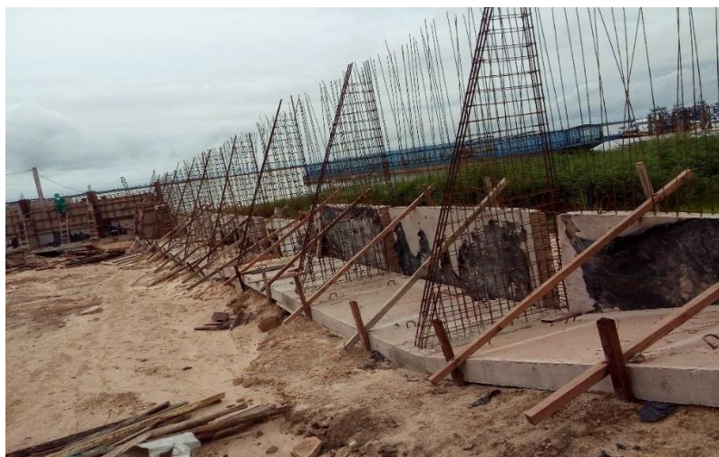
Figura 7: Armação dos contrafortes juntamente com as placas do fundo e verticais inferiores do muro.
